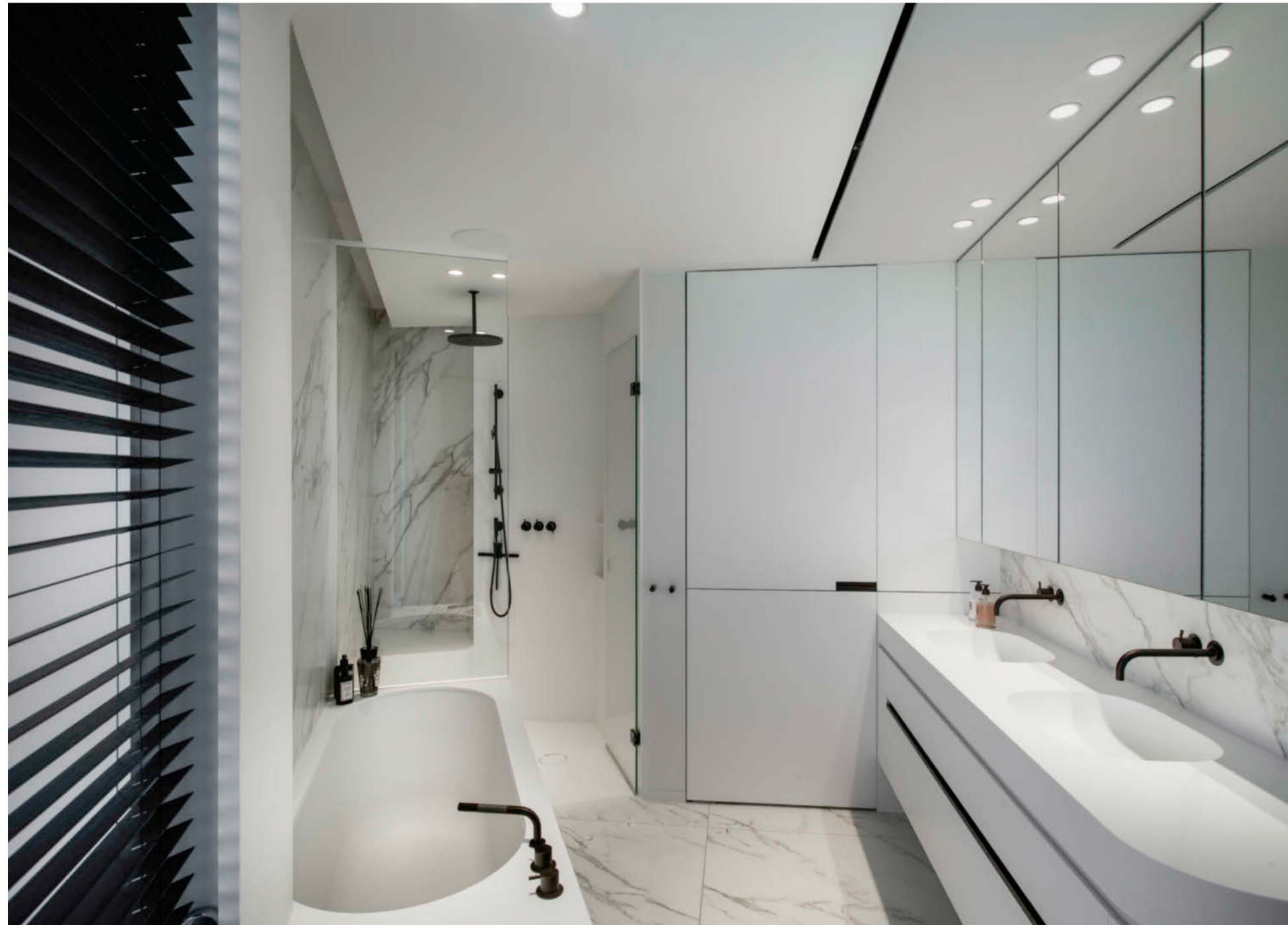
Erro Heating heeft zowel het sanitair als de ventilatie gerealiseerd in deze suitebadkamer. In de complete badkamer is natuursteen van André Celis Natuursteen verwerkt.
